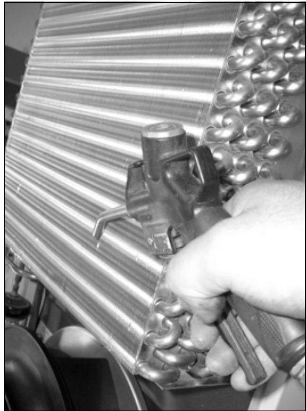
Abb. 80: Wärmetauschregister und Kompressorraum mit Druckluft ausblasen (2)
