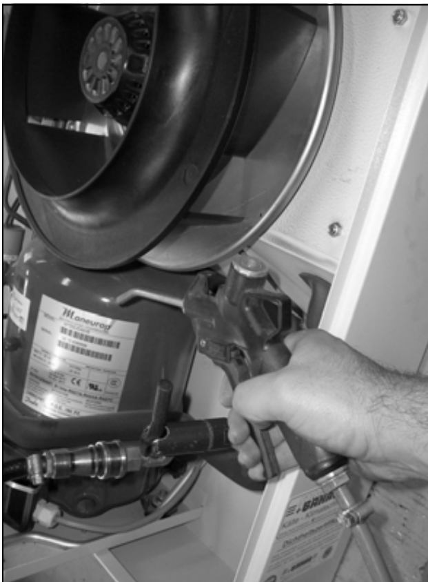
Abb. 57: Wärmetauschregister und Kompressorraum mit Druckluft ausblasen (2)
