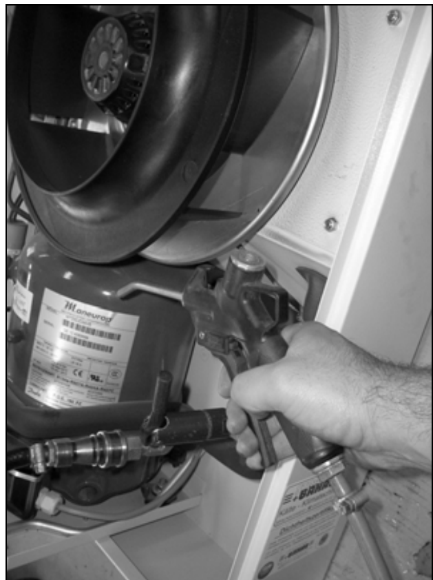
Abb. 81: Wärmetauschregister und Kompressorraum mit Druckluft ausblasen (3)
