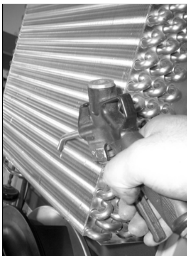
Abb. 56: Wärmetauschregister und Kompressorraum mit Druckluft ausblasen (1)
